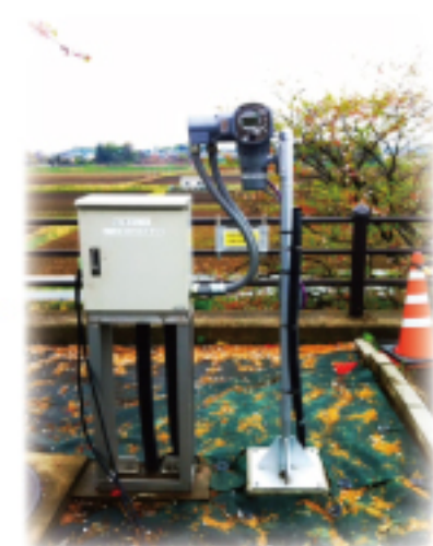
地上に設置された制御装置
