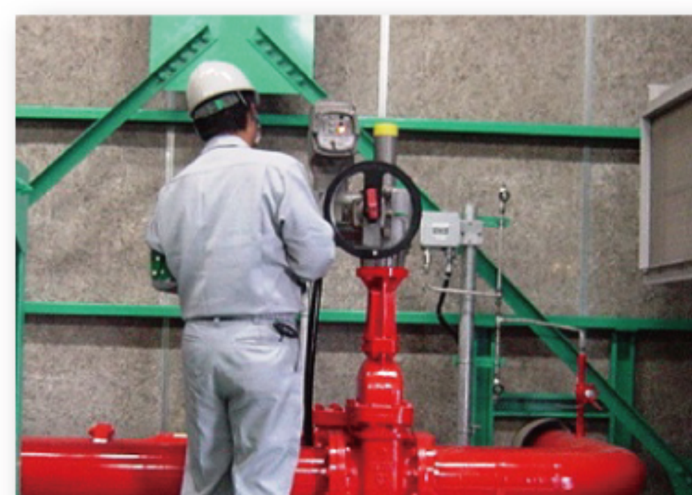
現地試運転調整
